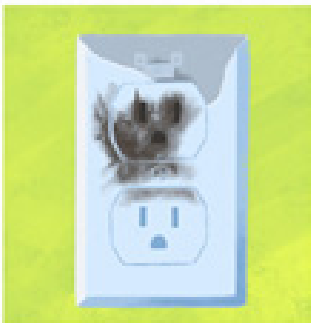
Prise de courant défectueuse
